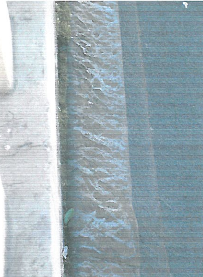
Fot. 23 Odklejona papa gzymsu na cokole balustrady
