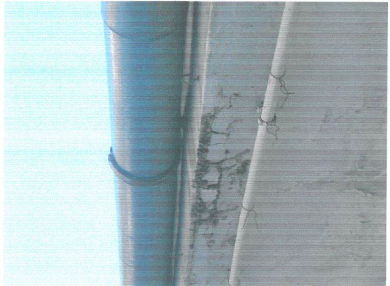
Fot. 24 Prześląkani wody z okapu gzymsu
