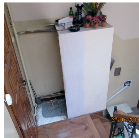
Nie zgodnie z prawem zainstalowany piec c.o. na paliwo stałe w klatce schodowej budynku wielorodzinnego służący do ogrzewania mieszkania.
