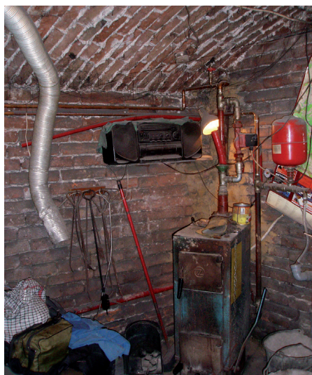
Nielegalnie zainstalowany piec c.o. na paliwo stałe - także bez projektu i pozwolenia na budowę, a włączenie pieca c.o. do nieszczelnych przewodów kominowych spowodowało zadymianie mieszkań położonych na pierwszym i drugim piętrze w budynku i stworzyło zagrożenie dla zdrowia i życia ich użytkowników.
